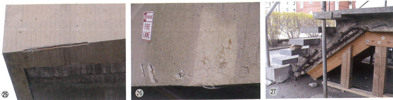
写真㉕～㉗ Begrisch Hall 躯体の不具合(鉄筋曝露、補修跡の再発、2008年に筆者が撮影)
