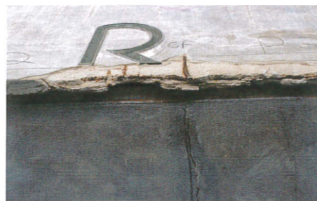
写真⑬ エントランス部上裏、先端部の水切溝付近に見られる錆鉄筋の露出。
