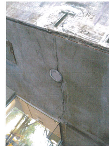
写真⑫ エントランス部付近、上裏面のひび割れと先端部に見られる錆鉄筋の露出。
